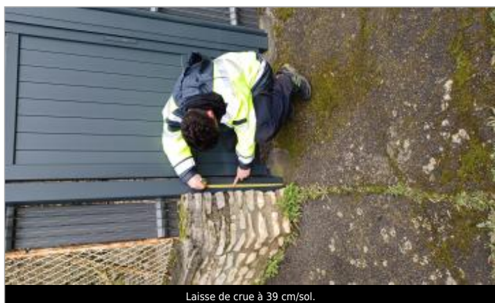
Laisse de crue à 39 cm/sol.
