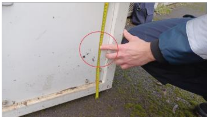
Laisse de crue à 26 cm/sol.
