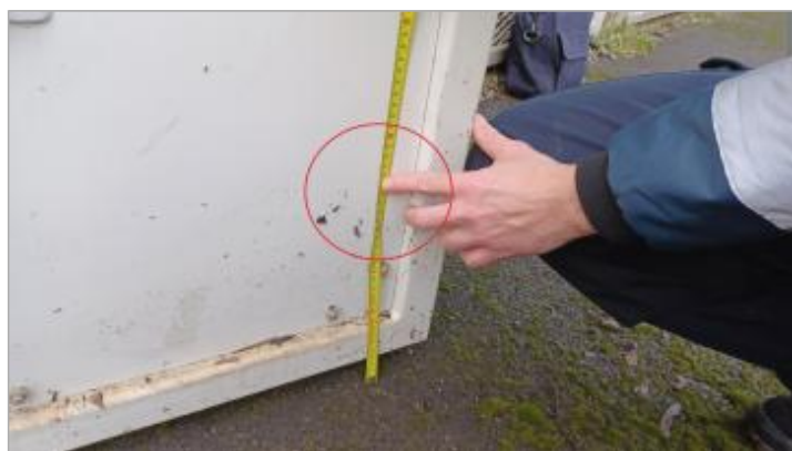
Laisse de crue à 26 cm/sol.
