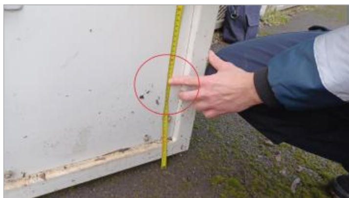
Laisse de crue à 26 cm/sol.
