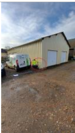
Laisse de crue à 51 cm/sol
