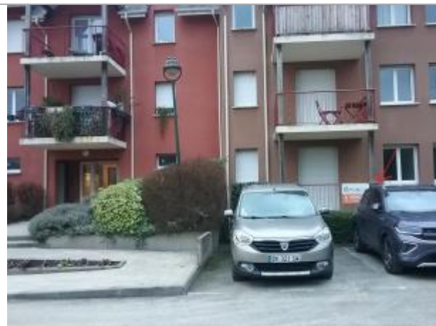
vue générale du site - situation du balcon par rapport à l'entrée du bâtiment C
