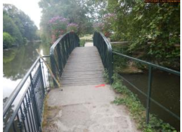
Vue du site en 2024, avec le repère de la crue de 2013
