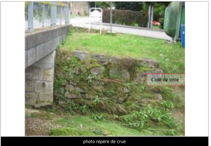
photo repère de crue
