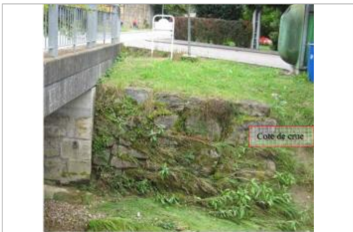
photo repère de crue
