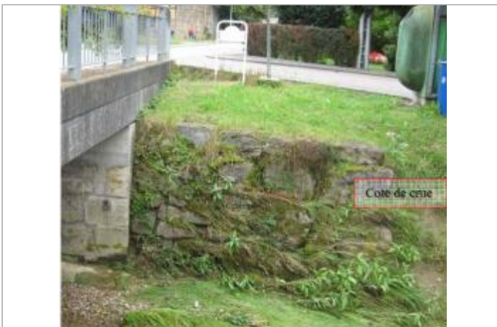
photo repère de crue
