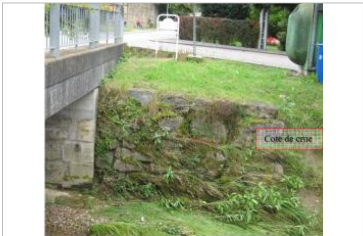
photo repère de crue
