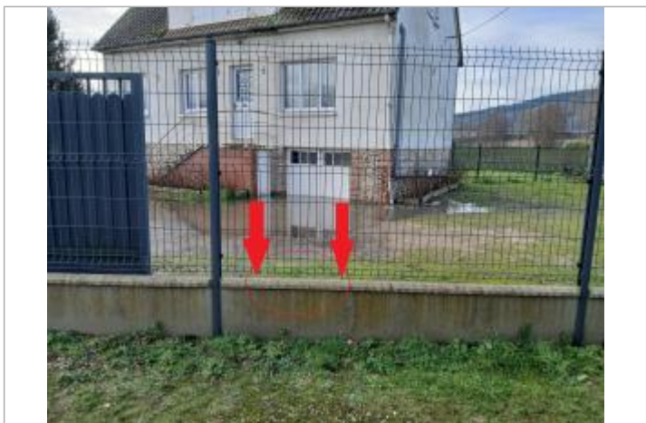
Leau est passé au dessus du muret à 45 cm/sol
