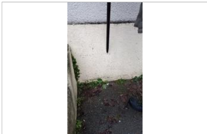
Vue sur la laisse d'inondation déposée sur le mur
