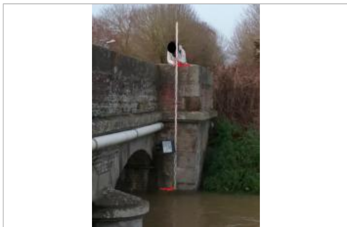
Pile de pont gauche, face aval, pont de Jort - Vue depuis la rive droite
