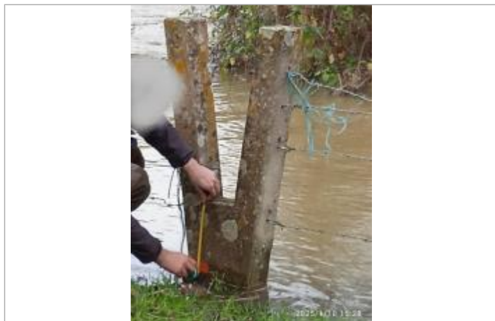
Marque peinte à 27,5cm depuis le haut (base du V), passage pêcheur en Y béton (source DDTM14)
