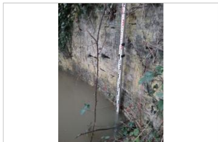
accumulation de végétaux sur la pile de l'ouvrage
