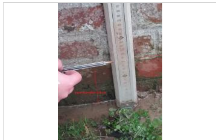
Trace d'humidité sur le muret en brique depuis le sol
