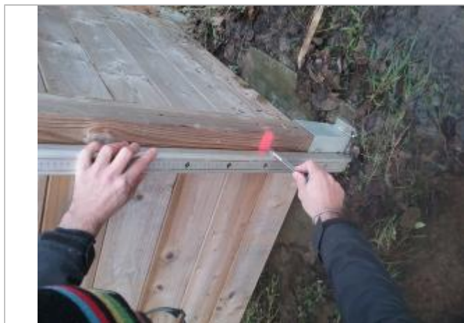
Relevé de la marque peinte depuis la base métal du pied en bois du local poubelles (28,5 cm)
