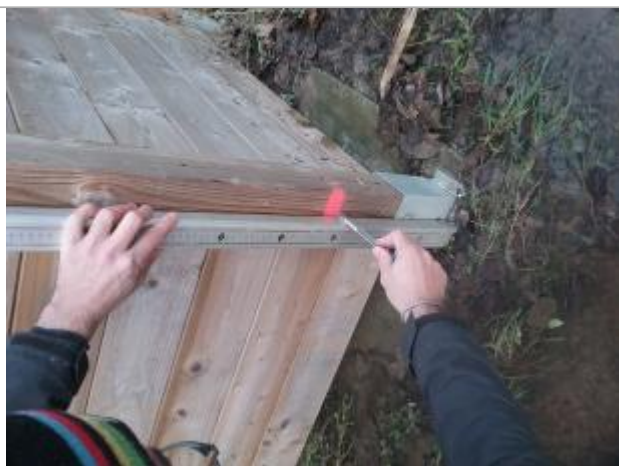
Relevé de la marque peinte depuis la base métal du pied en bois du local poubelles (28,5 cm)
