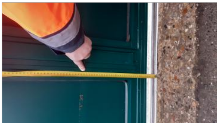
laisse de crue sur le portail, 34.5 cm à partir du sol
