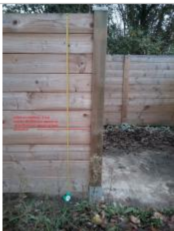
débris de végétaux sur la paroi en bois du local poubelle, à gauche de l'accès à la zone de stockage des déchets jaunes
