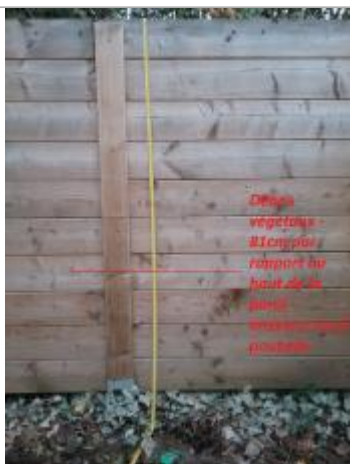
débris de végétaux sur la paroi en bois au fond du local poubelle du chemin du pont du tonnerre.
