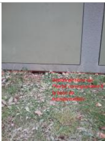
pente au droit du poste de tranformation (dépôt de sédiments sur l'herbe)
