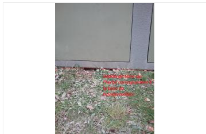
pente au droit du poste de tranformation (dépôt de sédiments sur l'herbe)
