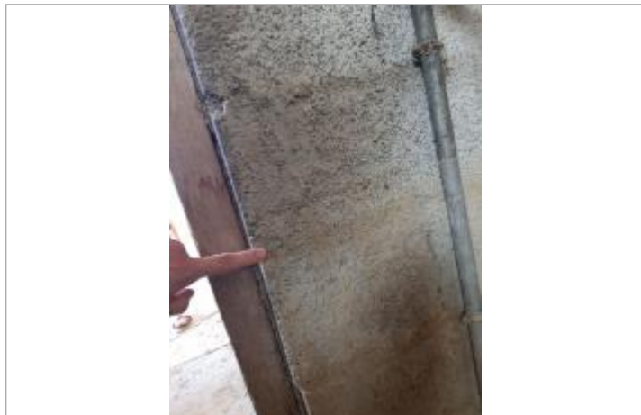
Intérieur du lavoir communal (fermé à clé), traces au mur
