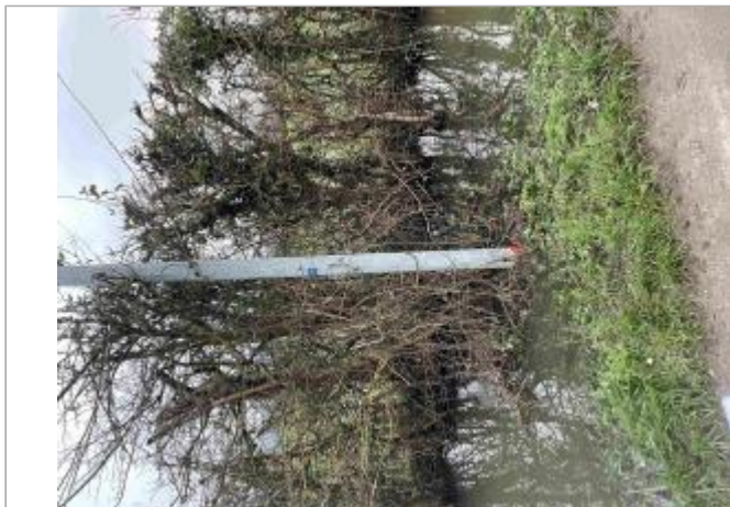
Poteau électrique n°135597/chemin de la pature/côté gauche dos à la maison
