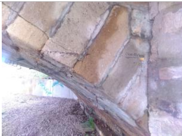
Laisse d'inondation et marque au crayon sous la première arche du pont, en 2024
