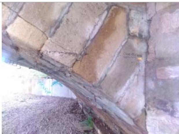
Laisse d'inondation et marque au crayon sous la première arche du pont, en 2024
