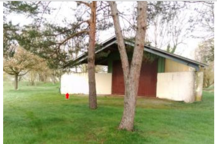
Vue du site en 2024 avec la laisse de la crue de mars 2024
