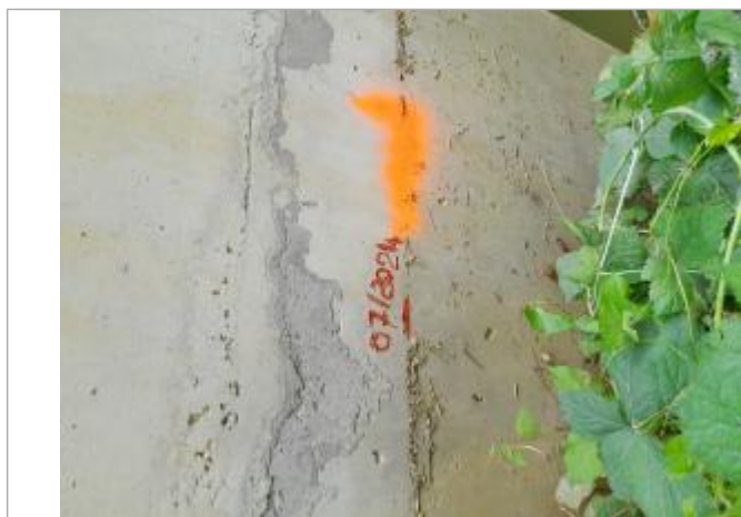
Marque de peinture sur la pile aval rive droite
