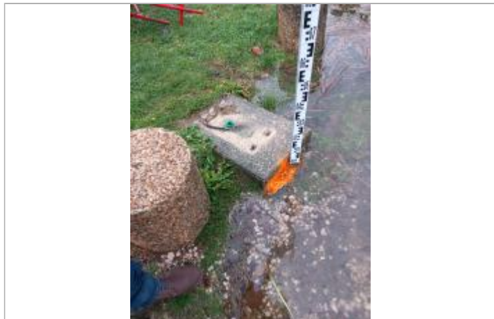
4 cm sous la surface de la fondation béton (entrée du parking)
