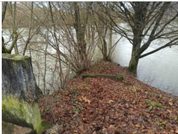
Au pied d'un arbre en amont du pont
