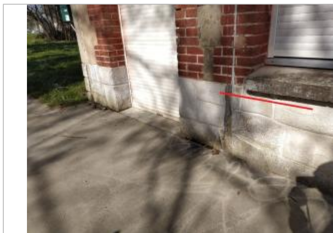
Relevé de laisse d'inondation sur la maison de quartier
