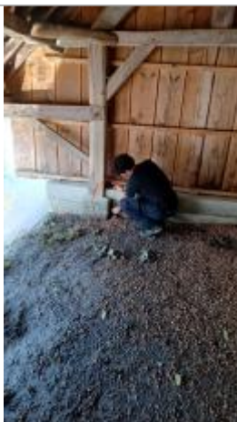
Laisse de crue à -20 cm/haut du muret.
