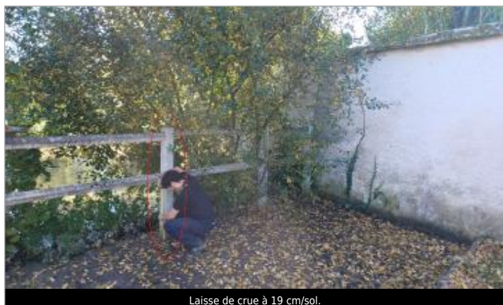
Laisse de crue à 19 cm/sol.
