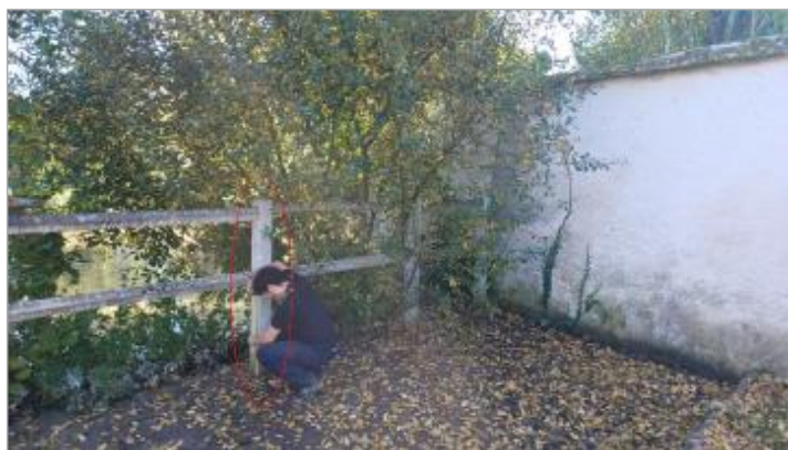
Laisse de crue à 19 cm/sol.
