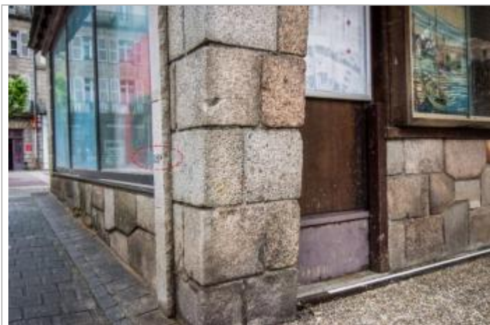
report de la laisse de l'inondation du 3 juin 2018 sur l'échelle en granit existante
