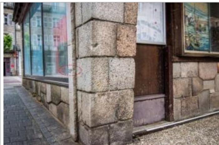
report de la laisse de l'inondation du 3 juin 2018 sur l'échelle en granit existante
