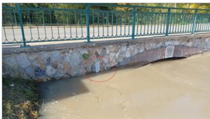
L'eau atteint le niveau 174 cm sur l'échelle.
