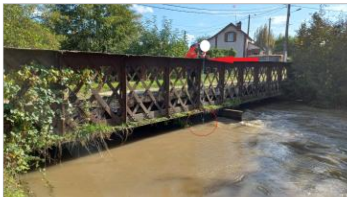
L'eau atteint le niveau -203 cm en dessous du haut du garde corps du pont.
