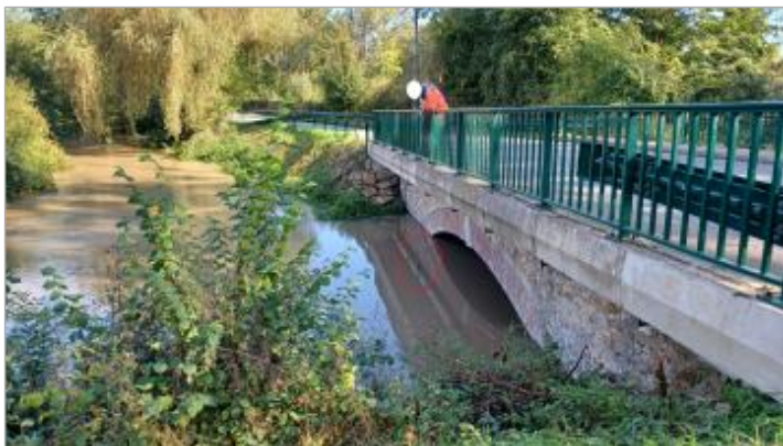
L'eau atteint le niveau -208 cm sous le tablier du pont.
