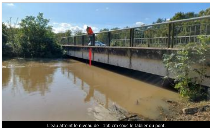
L'eau atteint le niveau de - 150 cm sous le tablier du pont.
