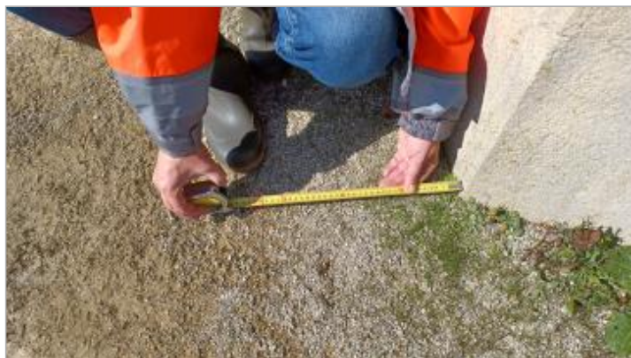
Laisse de crue au sol à 35 cm de l'arrête du mur.
