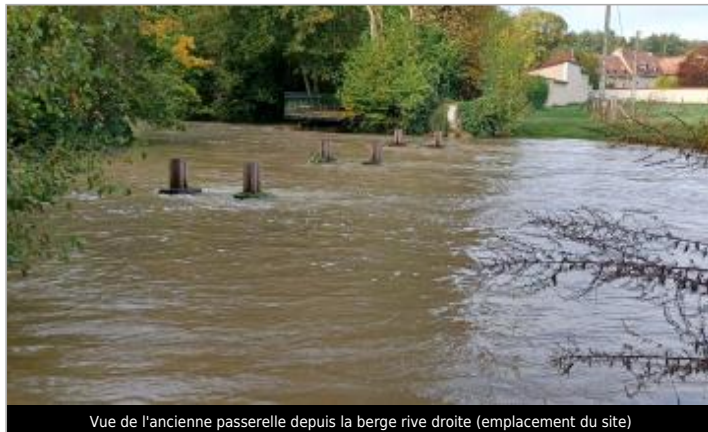
Vue de l'ancienne passerelle depuis la berge rive droite (emplacement du site)
