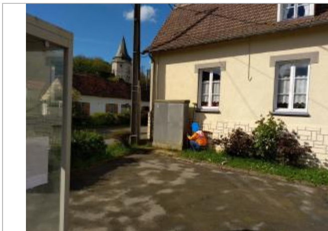
Le site est un coffret électrique.
