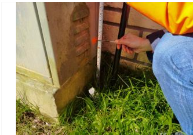
Le repère est situé sur un coffret électrique.
