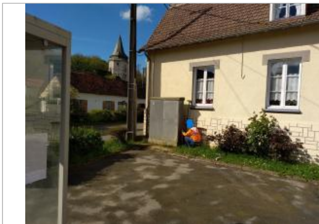
Le site est un coffret électrique.
