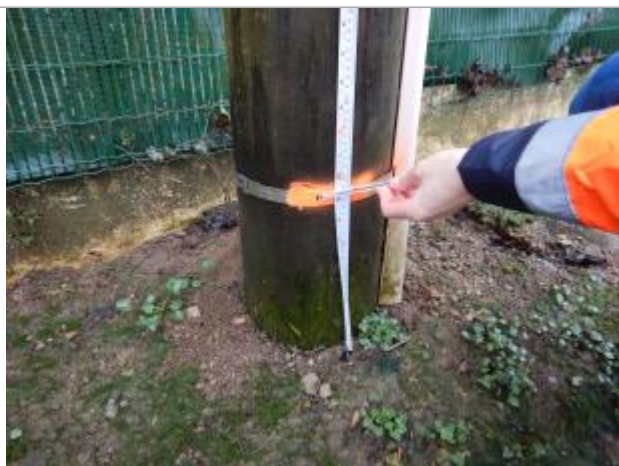
Le repère est au pieds d'un poteau électrique en bois.
