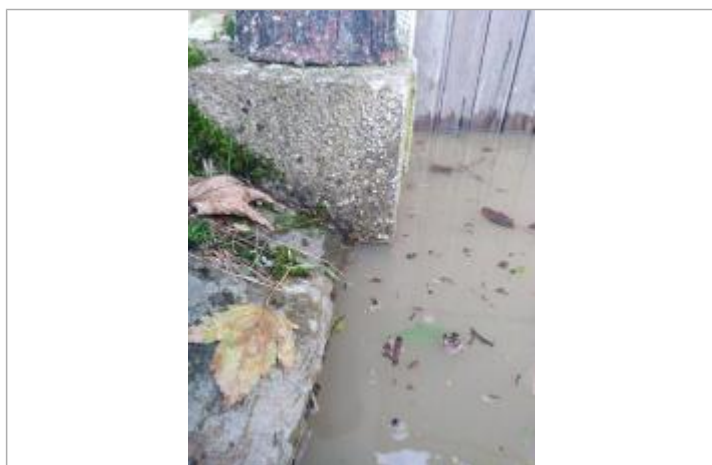
Vue sur le niveau d'eau à 5 cm environ du niveau de la marche devant le pilone (source : SPC SACN)
