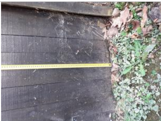
Dépôts sur la porte de garage
