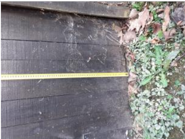
Dépôts sur la porte de garage
