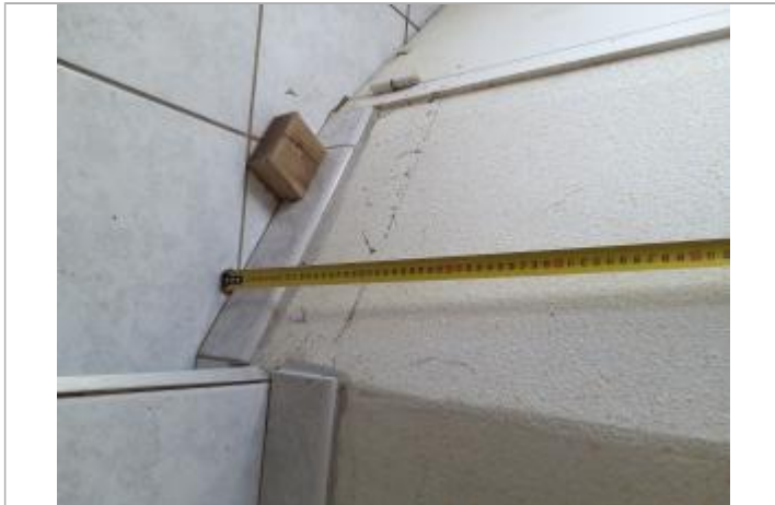
Laisse de crue - Point accueil de jour, arrière du bâtiment
