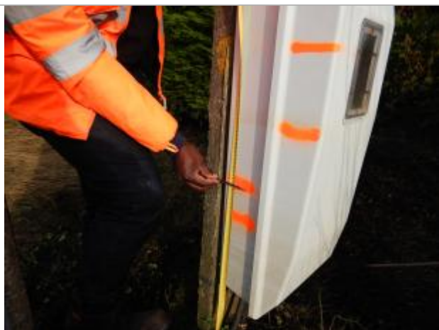
Le repère se trouve sur un coffret électrique
