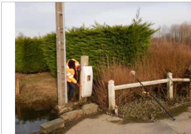
Le site est un coffret électrique
