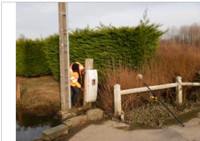
Le site est un coffret électrique
