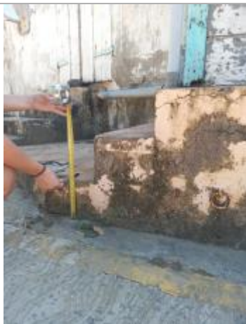
Dépôts de matières solides
