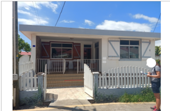
Hauteur d'eau arrivée à la deuxième marche
