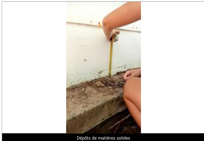
Dépôts de matières solides
